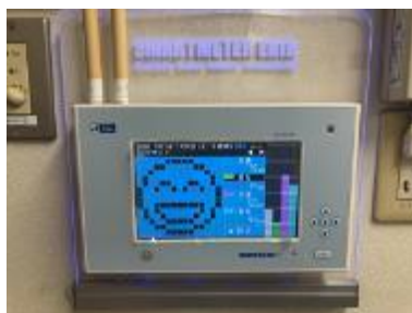
管理機器（事務所設置）
